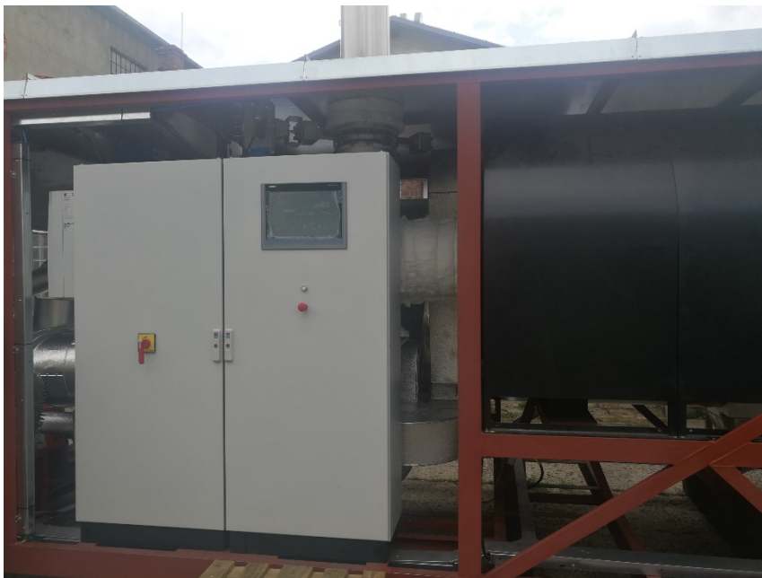
Obr. 14 rozvodná skříň pro ovládání celého zařízení. Na pravých dveřích dotyková obrazovka pro ovládání celého systému. Počítač je vybudován na platformě Siemens. Vpravo zadní část dospelovací komory.
