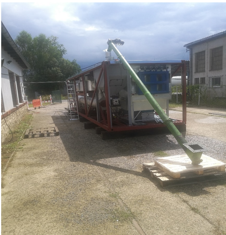
Obr. 15. Vstupní část celého zařízení sloužící pro dopravu vysušených kalů do násypky retorty
