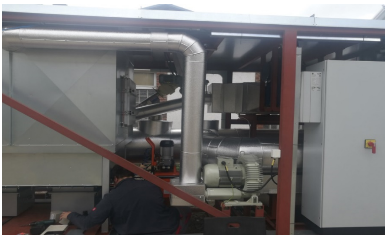
Obr. 11. pohled vlevo na filtrační jednotku s troubou vedoucí ke dmychadlu zajišťujícím podtlak v celém systému. Vpravo část rozvodné skříně s elektronikou
